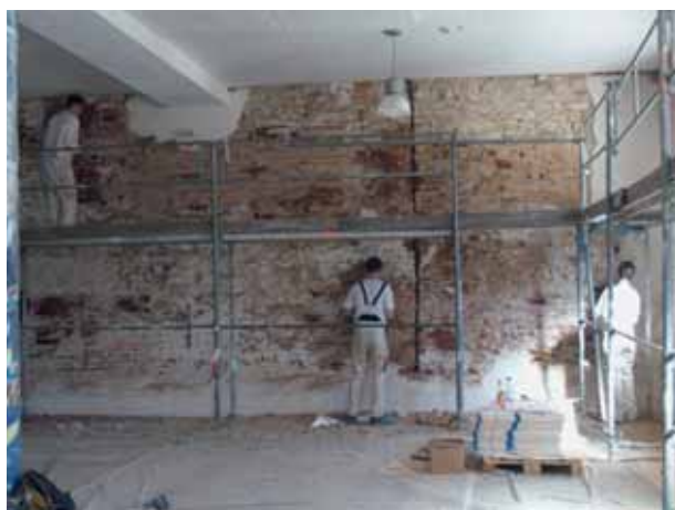
4 Los ging es mit der Untergrundvorbereitung. Nur selten haben Auszubildende die Möglichkeit, ihre Fähigkeiten so großflächig einzuüben. (Foto: Schloss Kapfenburg)
